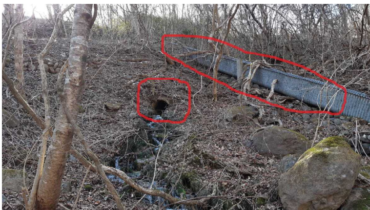
写真1 尚仁沢のD点付近で右岸を見上げると見られた排水管類。赤丸の所。
