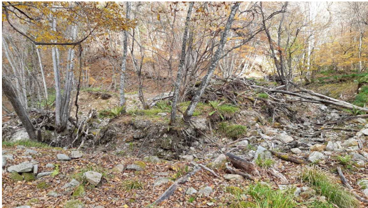
写真7 「銅山沢」の出会いの現状。その1。林道及び橋、出会い一帯は土石で埋もれてしまった。10年前の沢の出合の形状は全く消えてしまっていた。後になって、この土石の下にコンクリート製の橋の痕跡を確認することとなった。
